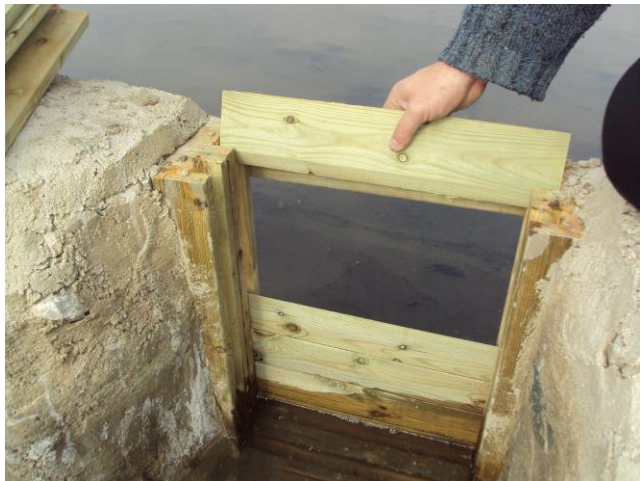
Fig. 6: Detalle de compuertas centimétricas para el control de niveles en El Rasall
