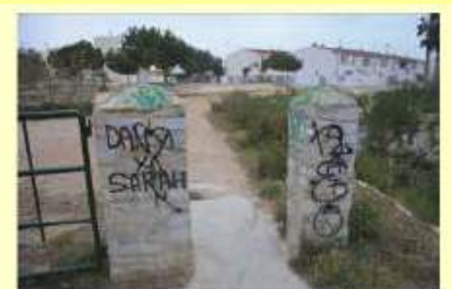
Pintadas a limpiar en el acceso desde El Mojón
