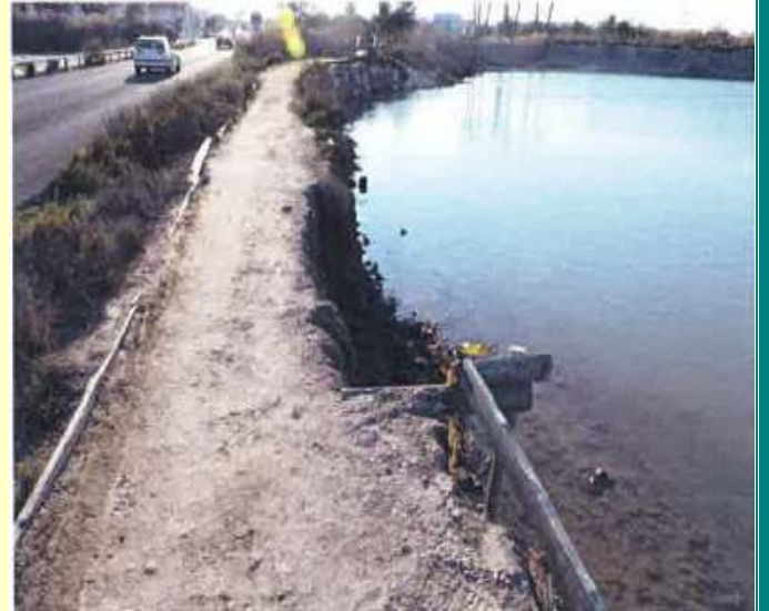
Desprendimientos en el tramo del Sendero de las Encañizadas que serán arreglados
